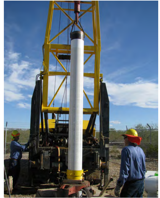
Personal de Tucson Water instalando una nueva pantalla en el pozo SC-003A
