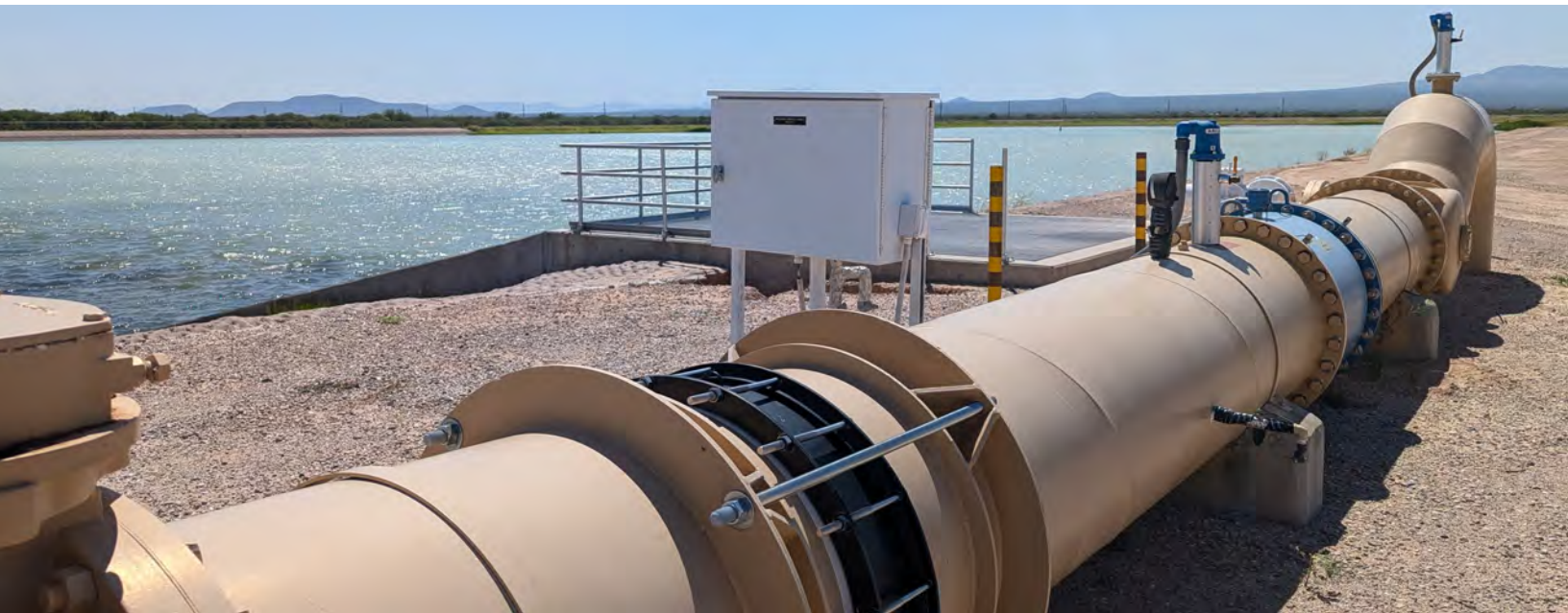
Cuenca de recarga en el Proyecto de almacenamiento y recuperación del sur del valle de Avra (SAVSARP)
